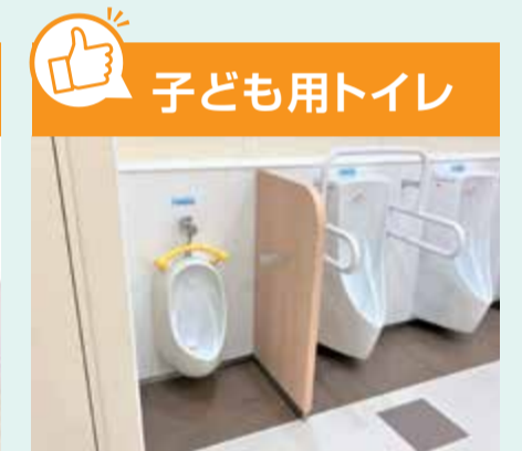
1、2階の男子トイレ(東側)には子ども用小便器を設置
